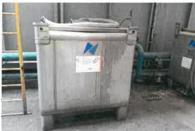
Foto 2: Utilizzo di prodotti chimici con bacino di contenimento
