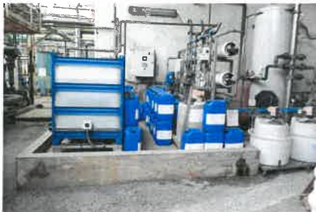
Foto 1: Utilizzo di prodotti chimici con bacino di contenimento
