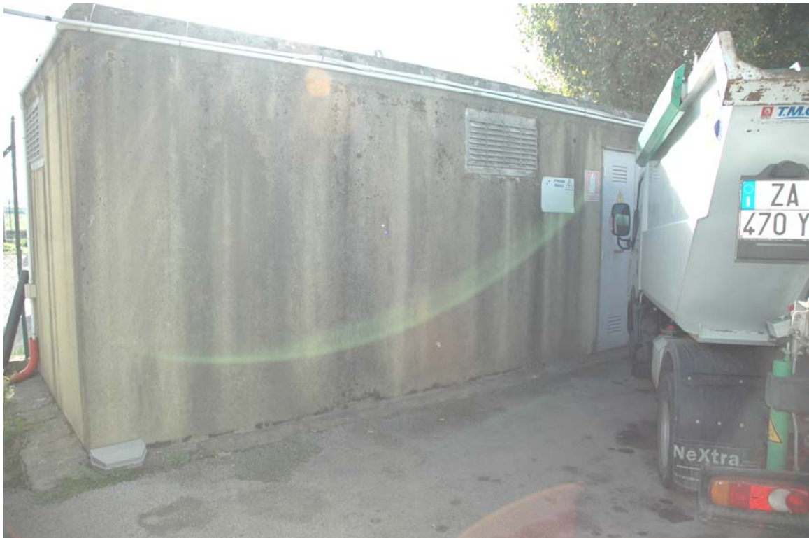
F. CABINA MT
