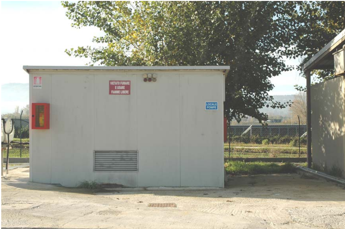
B. IMPIANTO ANTINCENDIO – LOCALE POMPE
