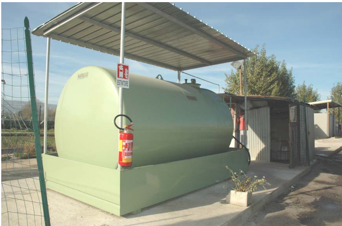
E. SERBATOIO GASOLIO
