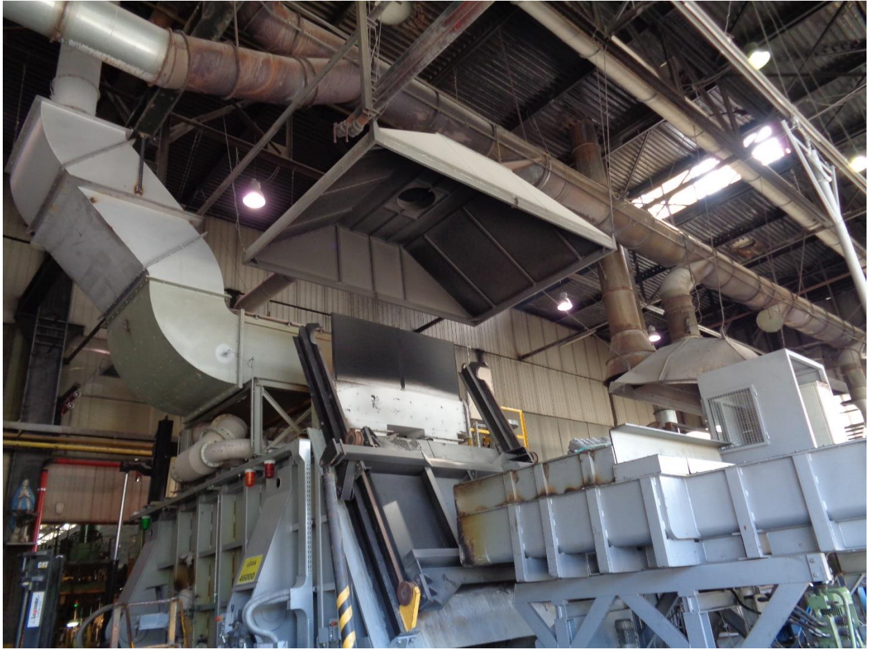
Cappe di aspirazione Area forni
