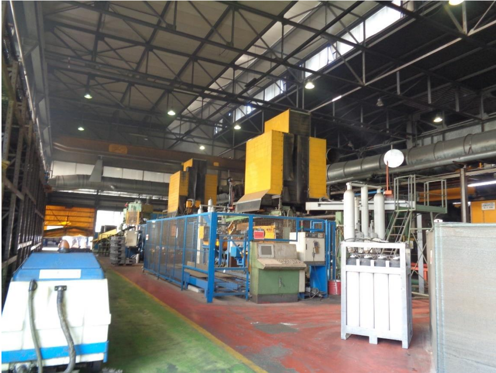
Cappe di aspirazione Area forni
