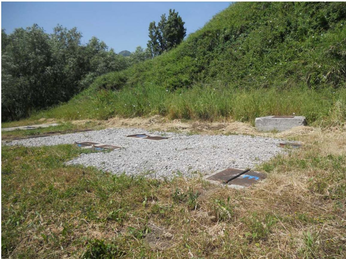
Figura 3.4 - Veduta di una parte dell'impianto di trattamento delle acque meteoriche esistente
