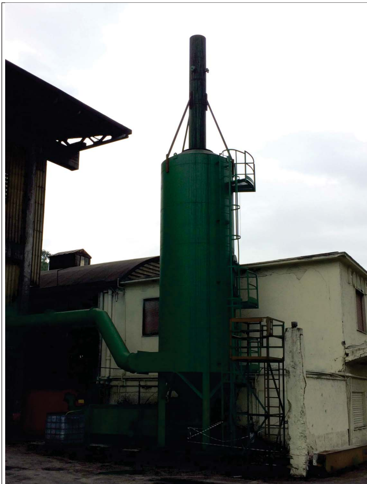
Figura 2.10 – Fonderie Pisano: stralcio fotografico della sorgente emissiva E9 – camino (Data: maggio 2016).
