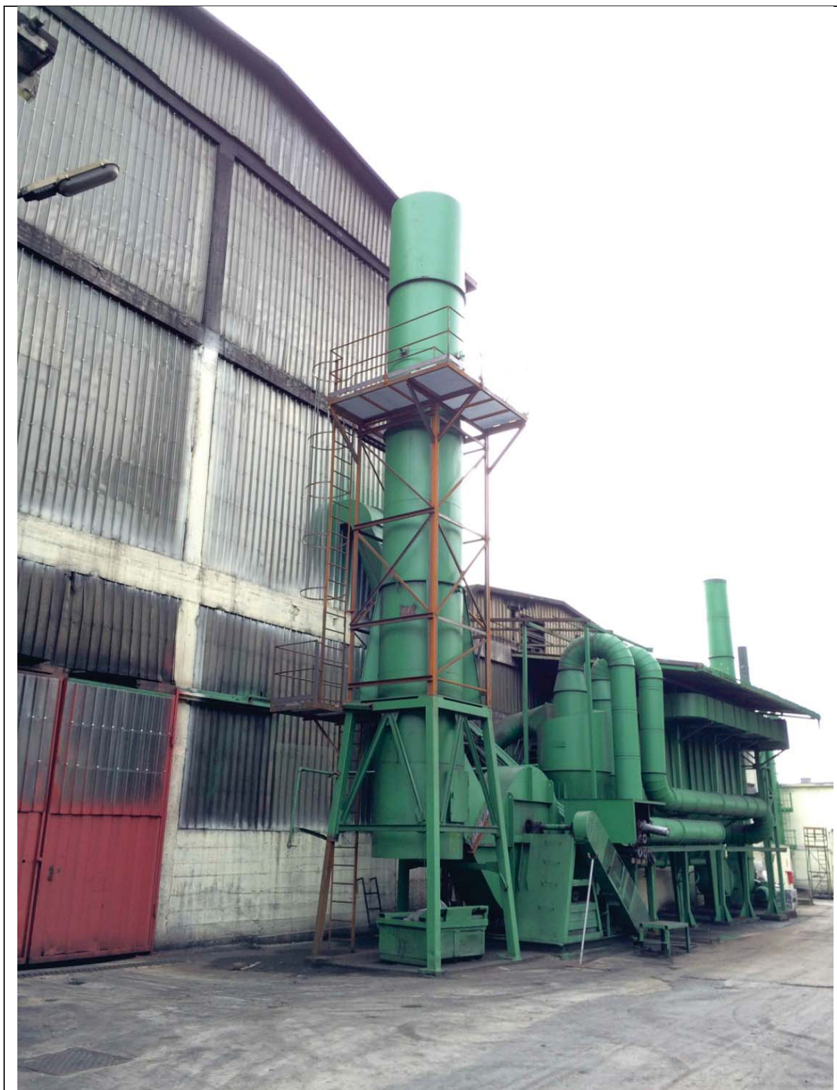
Figura 2.8 – Fonderie Pisano: stralcio fotografico della sorgente emissiva E7 – camino (Data: maggio 2016).
