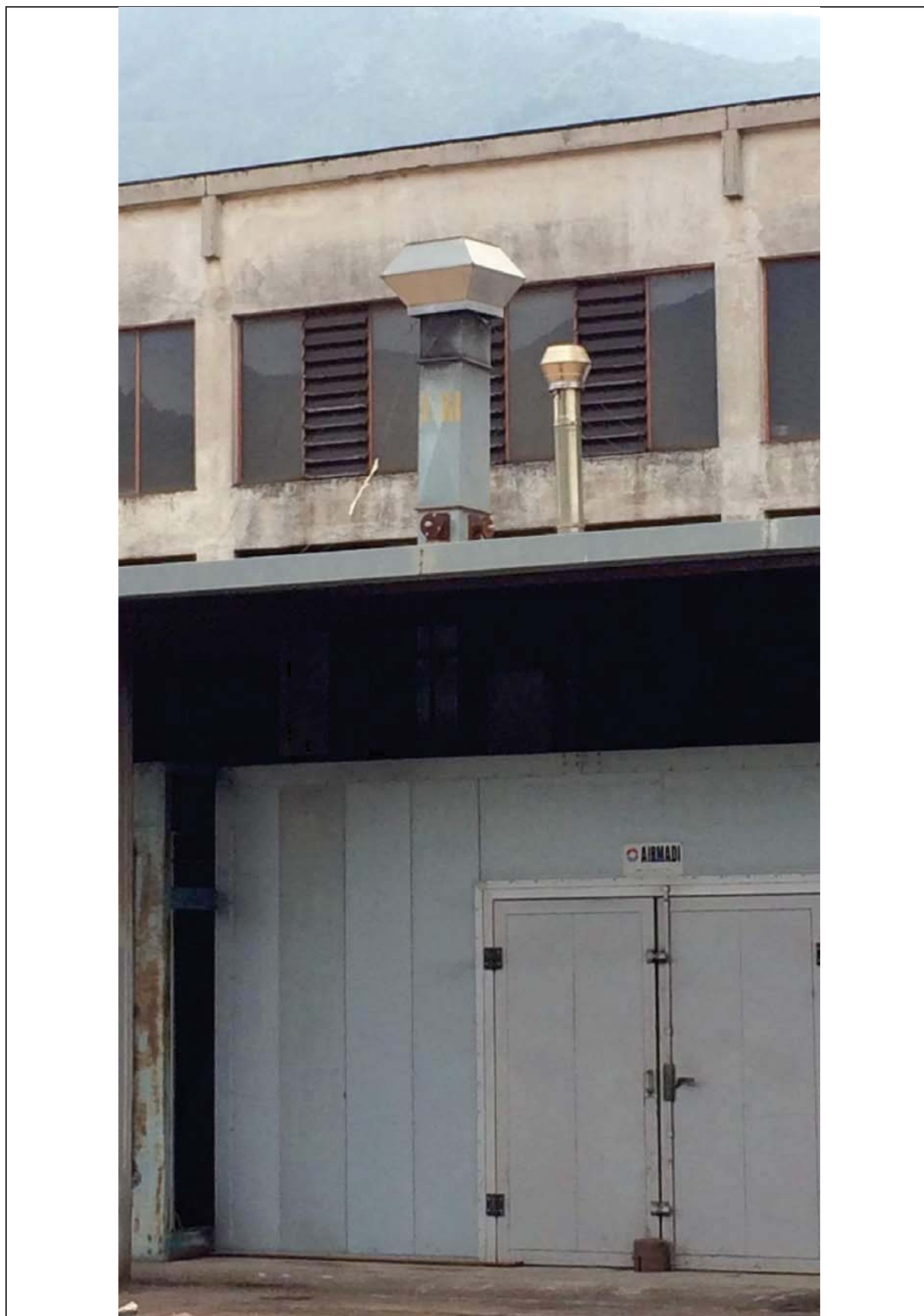
Figura 2.16 – Fonderie Pisano: stralcio fotografico della sorgente emissiva E16 – camino (Data: maggio 2016).
