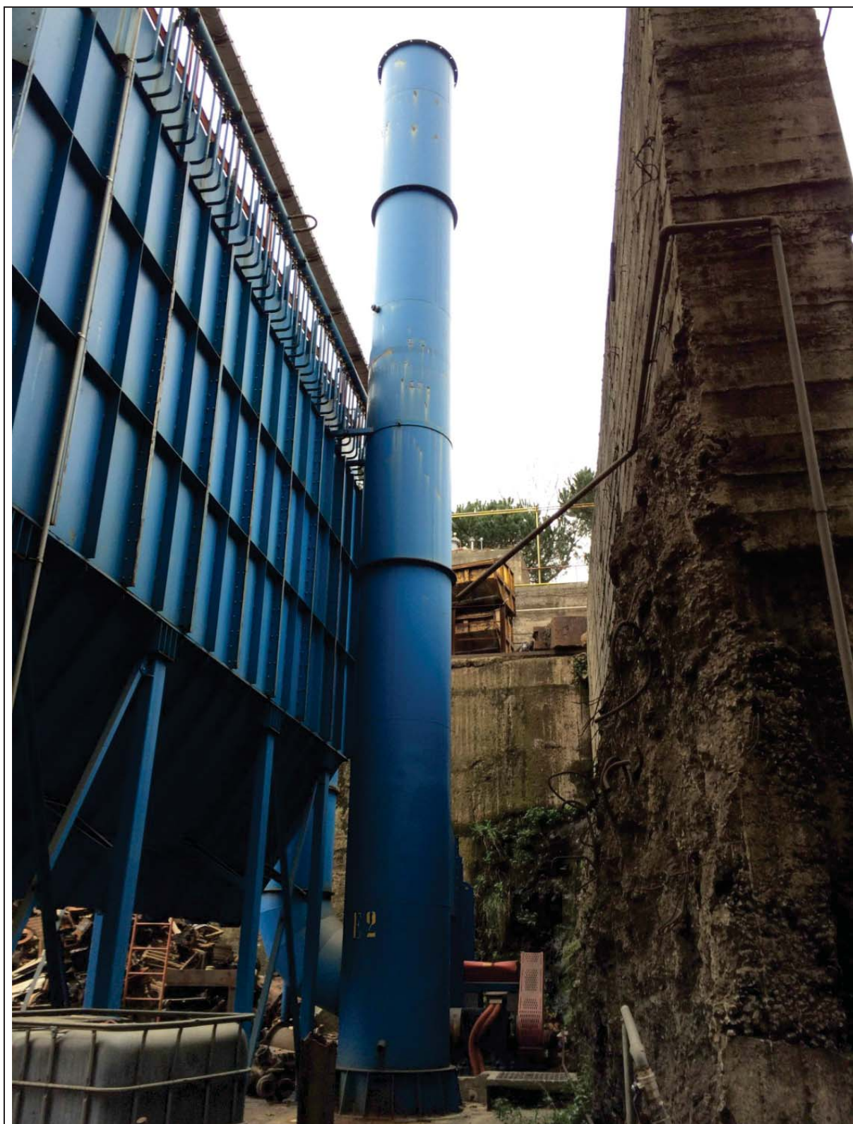
Figura 2.4 – Fonderie Pisano: stralcio fotografico della sorgente emissiva E2 – camino (Data: maggio 2016).
