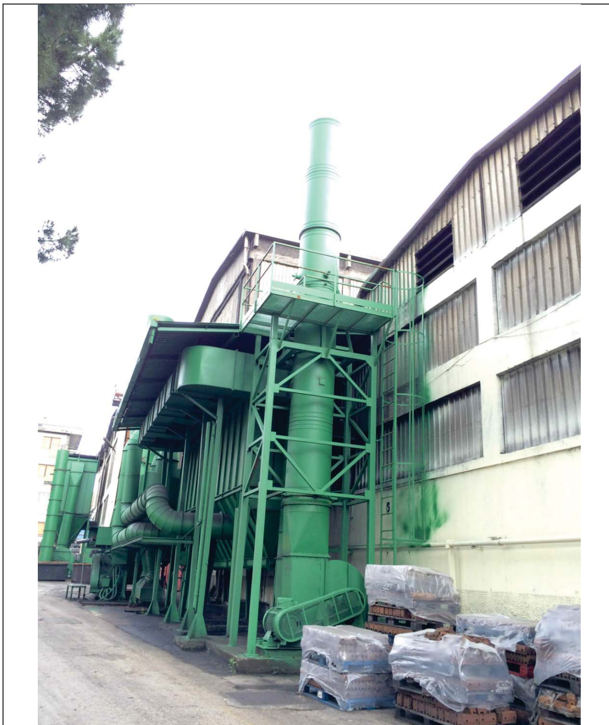
Figura 2.9 – Fonderie Pisano: stralcio fotografico della sorgente emissiva E8 – camino (Data: maggio 2016).
