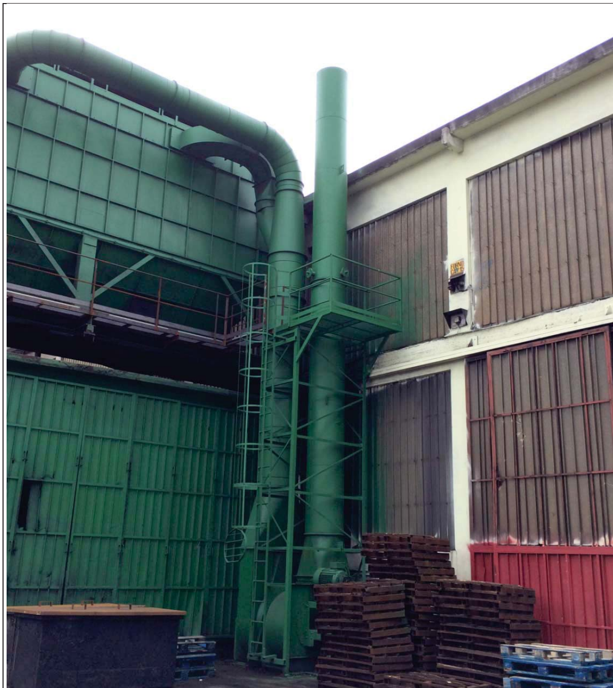
Figura 2.6 – Fonderie Pisano: stralcio fotografico della sorgente emissiva E4 – camino (Data: maggio 2016).
