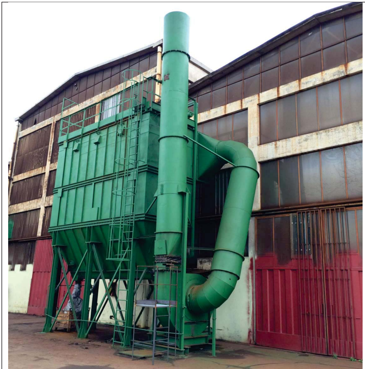
Figura 2.14 – Fonderie Pisano: stralcio fotografico della sorgente emissiva E14 – camino (Data: maggio 2016).
