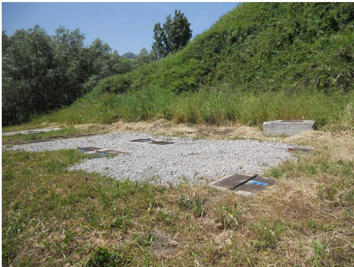
Figura 4.2 - Veduta di una parte dell'impianto di trattamento delle acque meteoriche esistente
