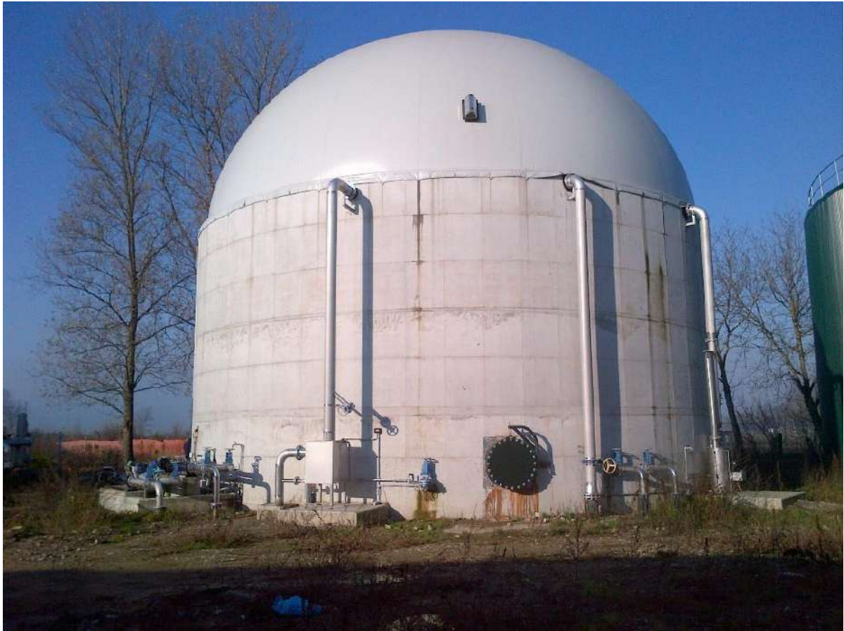
Figura 1.2.5.c - Esempio di digestore freddo e copertura gasometrica.
