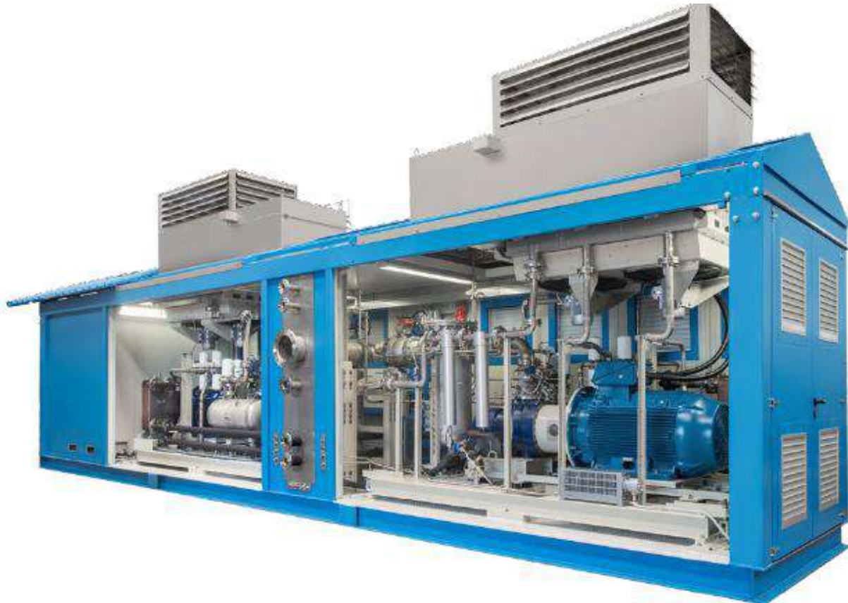
Figura 16 - Tipico sistema di gruppo compressione biogas grandi portate a 16,5 bar
