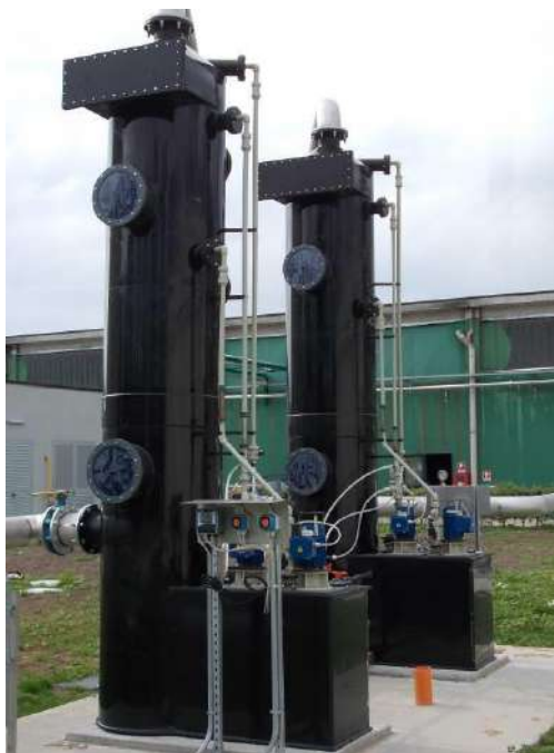
Figura 1.4.1-a - Esempio di torri di lavaggio.
