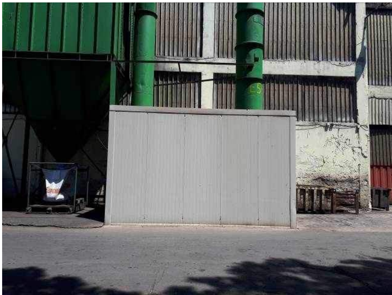
Fig.1 Cabina di insonorizzazione per i motori del camino E5-6 (Filtro F5 fase di sabbiatura)
