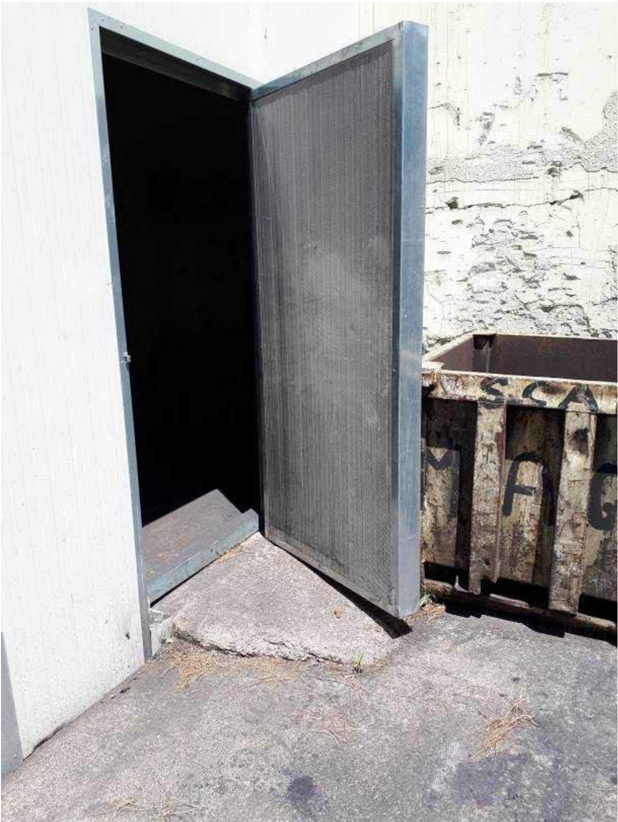
Fig. 2 Particolare della cabina di insonorizzazione dei motori del camino E5-6
