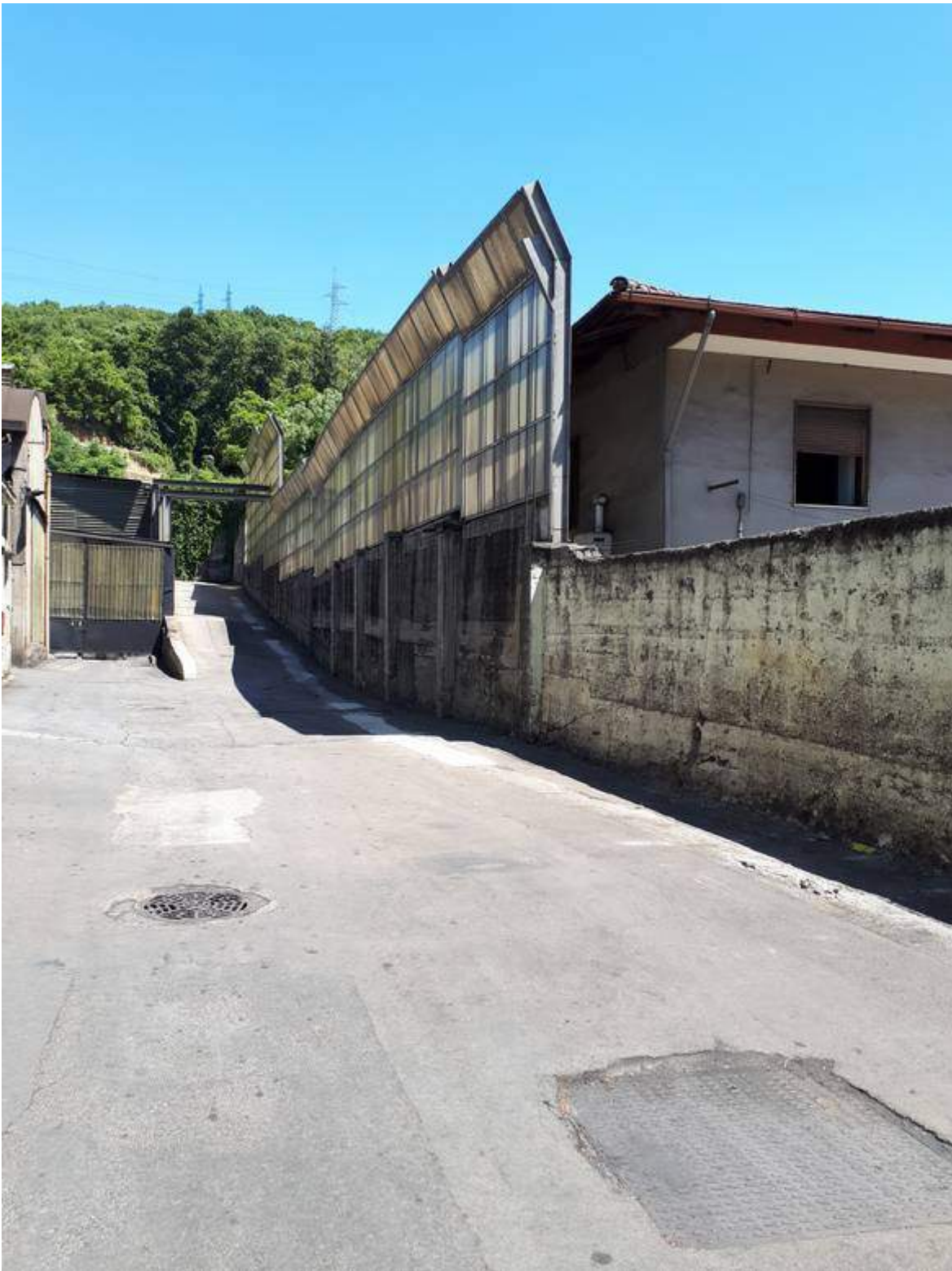
Fig. 7 Barriera in materiale plastico a protezione del vicino ricettore (copertura visiva e protezione polveri)
