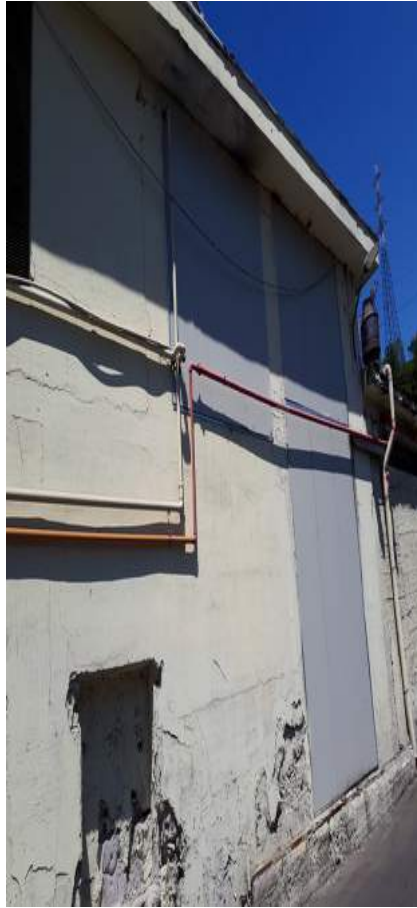
Fig. 6 Barriere fonoassorbenti applicate alle aperture della sala compressori
