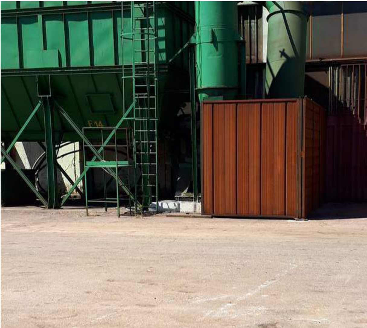
Fig. 5 Barriere fonoassorbenti per il camino E14 (sbavatura meccanica)
