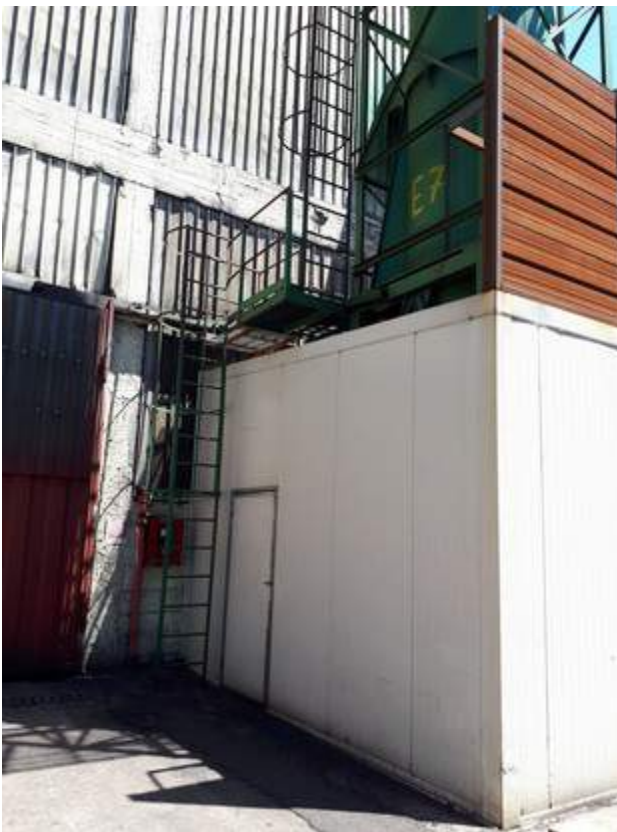
Figg.3a e 3b Sistemi di contenimento acustico (cabina e barriere) del camino E7 (impianto terre)
