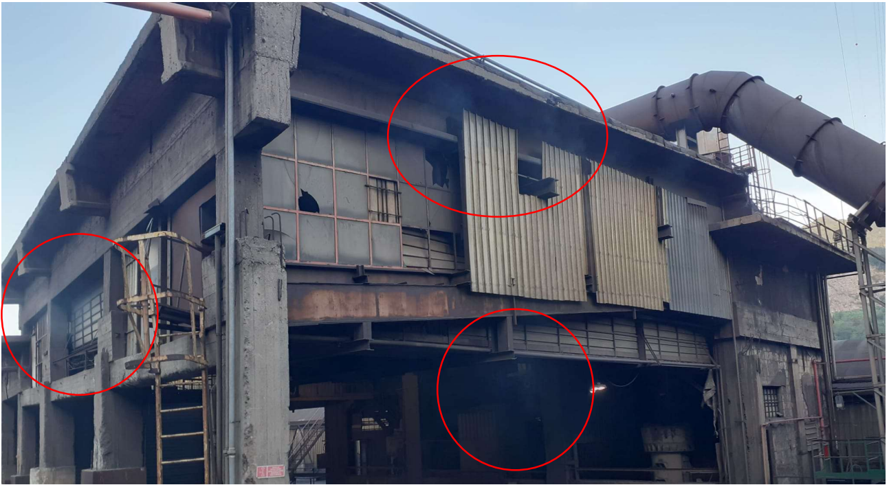
Fig.6 –foto della tettoia sovrastante l’area di carico dei forni in cui sono visibili le emissioni di fumo (area cerchiata in rosso)
