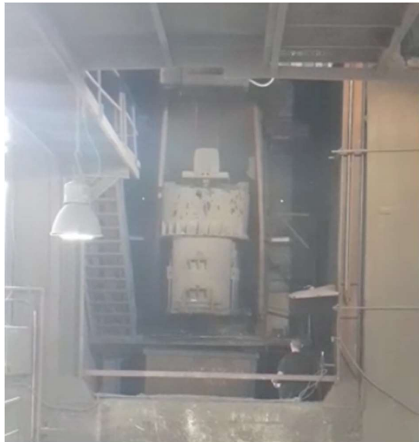
Fig.4 –ingresso benna di carico nel forno “cubilotto”
